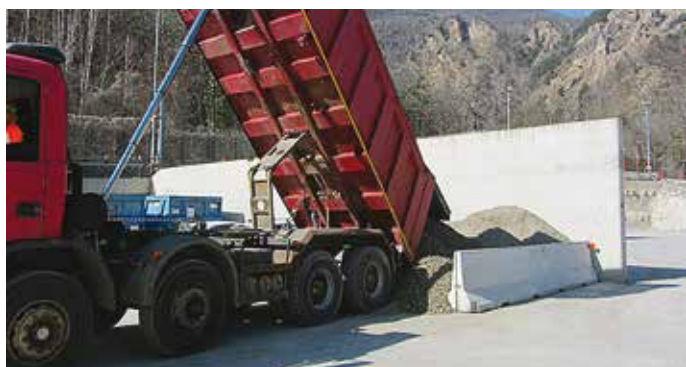
7. L'attività di fornitura della ghiaia per la sistemazione del fondo del cunicolo al cantiere TELT-Nicchie
